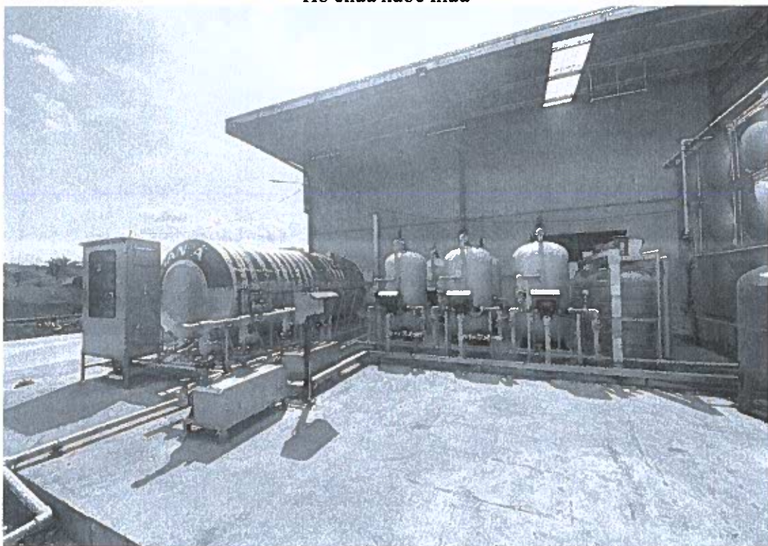
Chi tiết hệ thống xử lý nước cấp
