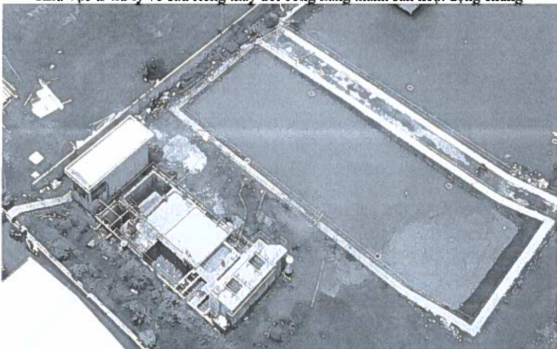
Hệ thống xử lý nước thải và hồ sự cố
