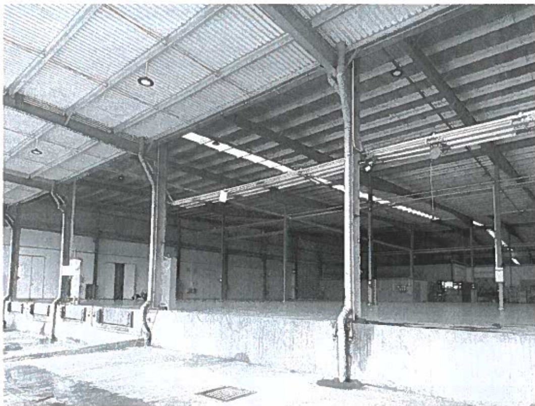
Hệ thống thu gom nước mưa mái
